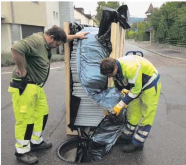
Einzug des vorkonfektionierten Liners über den Kontrollschacht in die zu sanierende Abwasserleitung.
