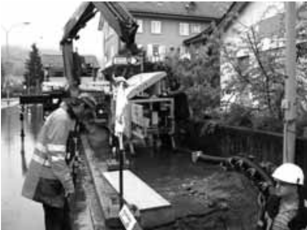
Hochspannungskabelzug Büntstrasse – Neuhaus
